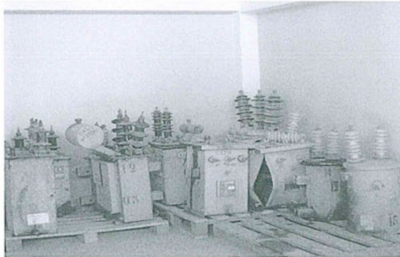
Fotografía 13: Almacenamiento de transformadores en Almacén de Residuos Peligrosos
