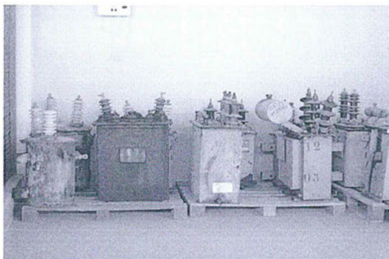
Fotografía 16: Almacenamiento de transformadores en Almacén de Residuos Peligrosos
