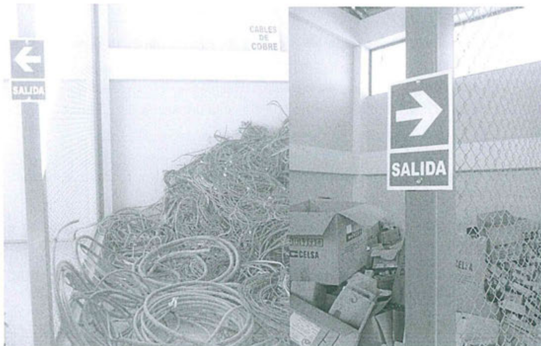
Fotografía 18: Ubicación de señalización de evacuación en Almacén de Residuos Peligrosos
