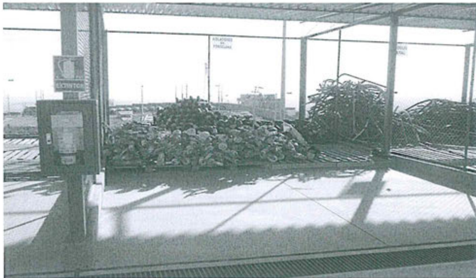
Fotografía 3: Almacenamiento de aisladores de porcelana y Ubicación de extintor de 6 Kg.
