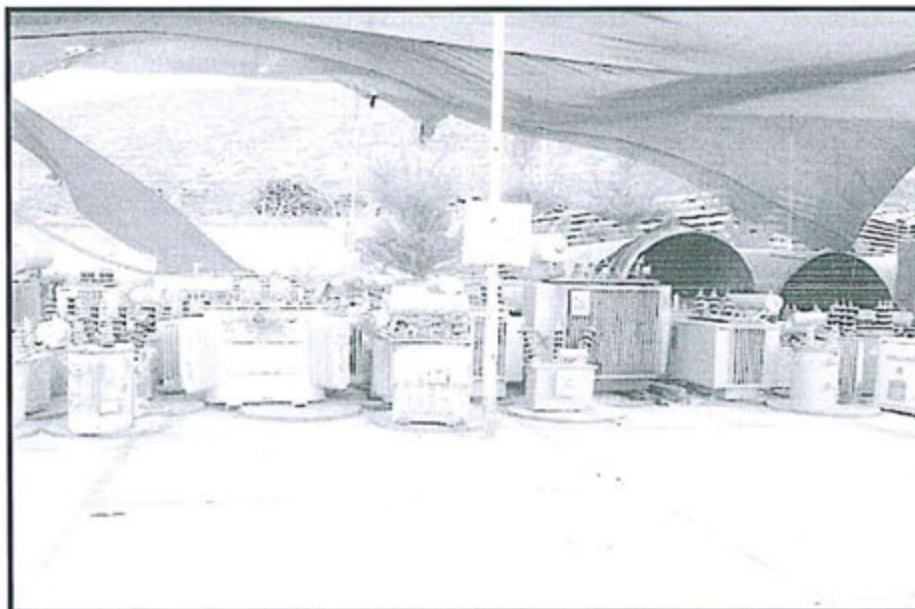
Fotografía N° 2: Vista de la SET Jesús donde se pueden observar transformadores y baterías ubicados en suelo permeable y a la intemperie
