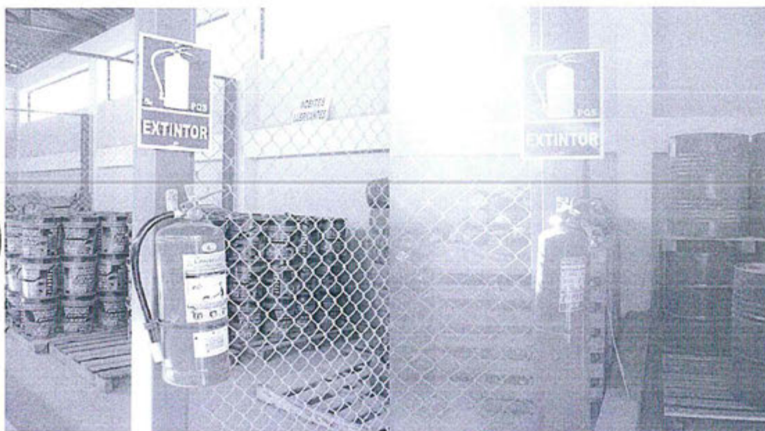
Fotografía 17: Ubicación y señalización de extintores de 6 Kg. En Almacén de Residuos Peligrosos
