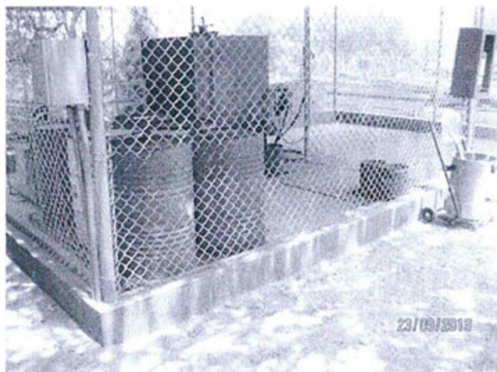
Vista 3. Sardinel para contención de posibles derrames de combustible por el tanque de almacenamiento de combustible
