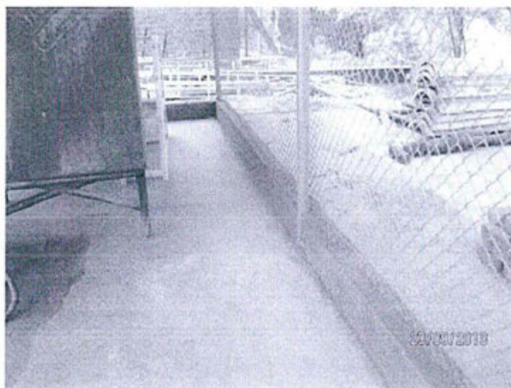
Vista 4. Sardinel para contención de posibles derrames de combustible por el tanque de almacenamiento de combustible
