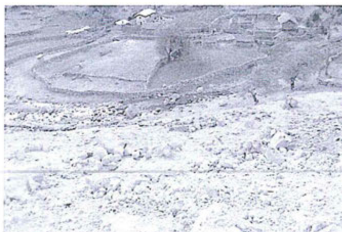
Fotografía 34: Material removido por la construcción de la vía de acceso, la cual llegó al cauce del río.
