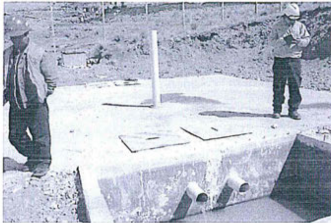
Fotografía 64: Pozo septico donde se disponen las aguas servidas.
