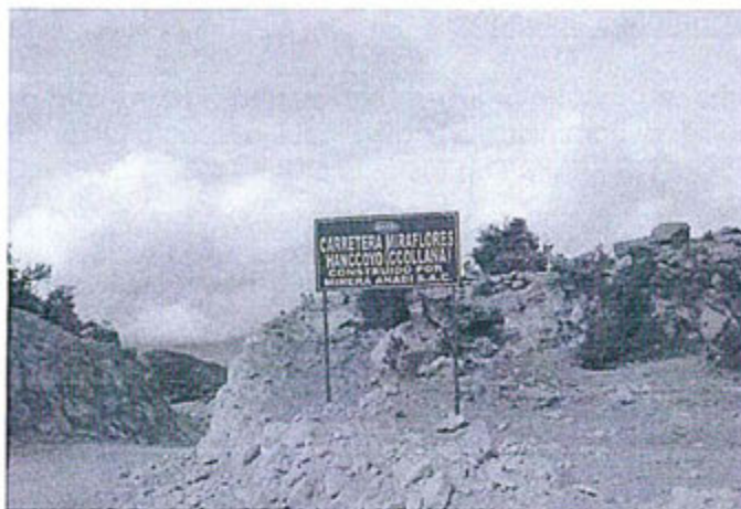
Fotografía 32: Letrero donde se confirma que Anabi S.A.C. ha construido vías de acceso sin certificación ambiental.
