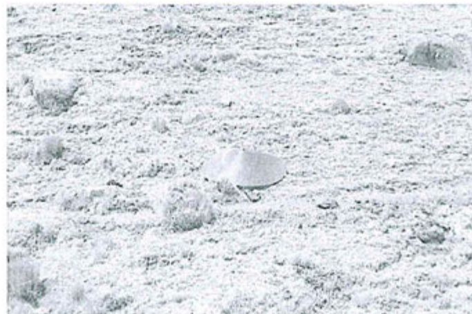
Fotografía 60: Presencia de restos de geomembrana sobre el suelo en áreas proximas a la quebrada Chonta.
