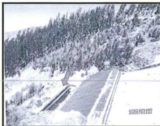
Poza de captación de sub drenajes con línea de derivación hacia la presa de relaves
