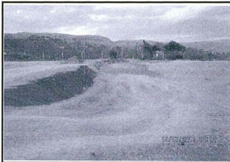
Fotografía N° 234.- Relleno sanitario que no cuenta con canal ni poza de colección de lixiviados
