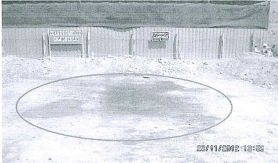
Fotografía N° 66.- Supervisión Regular 2012.- Observación N° 6.- En el área de estacionamiento de vehículos pesados adyacente al sector de lavado de vehículos de mina, ubicado en las coordenadas UTM: Este 223014 y Norte 8169064, se observó suelos impregnados con aceites y grasas.
