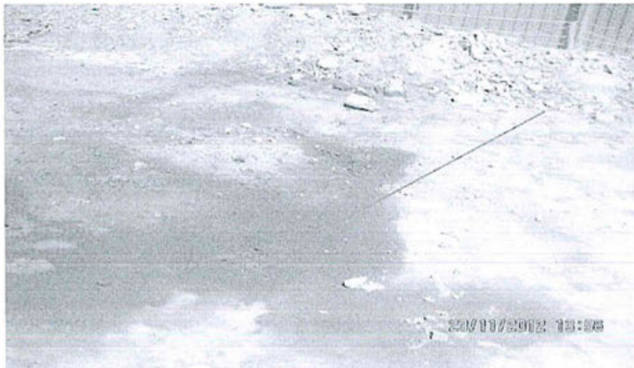
Fotografía N° 67.- Supervisión Regular 2012.- Observación N° 6.- En el área de estacionamiento de vehículos pesados adyacente al sector de lavado de vehículos de mina, ubicado en las coordenadas UTM: Este 223014 y Norte 8169064, se observó suelos impregnados con aceites y grasas.
