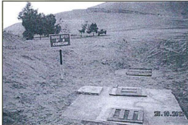
Fotografía N° 92: Verificación: el titular minero ha realizado el mantenimiento del Pozo Séptico N° 2
