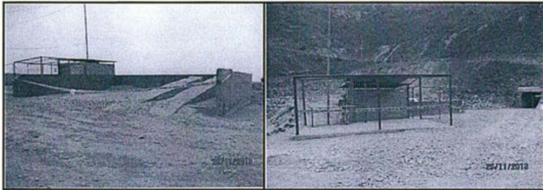
Fotografías N° 145 y 146: En el área adyacente a la bocamina del nivel 295, la losa que se destinaba al mantenimiento de máquina de mina se encontraba inoperativa.
