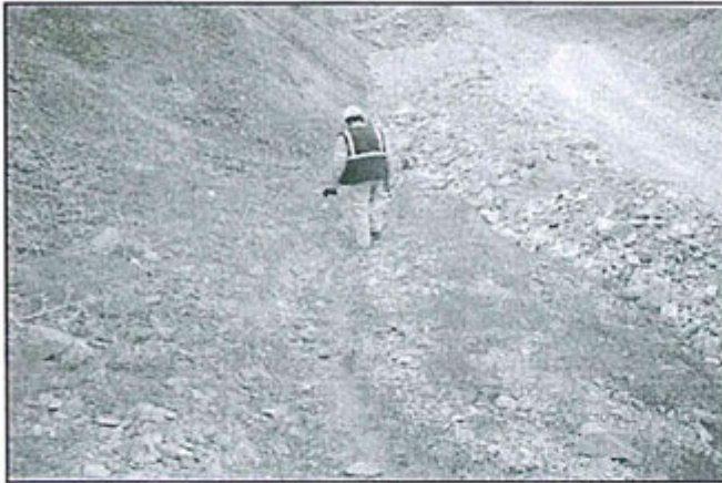
Fotografía N° 8: "Canal de coronación del depósito de desmorte Raúl, obstruido en un tramo de 90 metros (entre las coordenadas UTM (WGS-84) 327295 E, 8594302 N y 327364 E, 8594365 N)."
