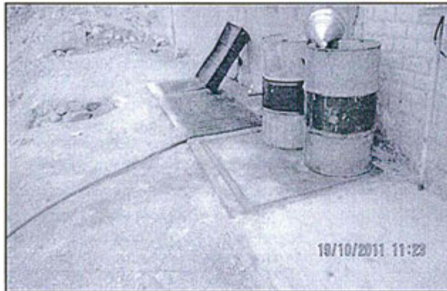
Fotografía N° 15: "Poza de sedimentación, sin poza de secado de lodos."
