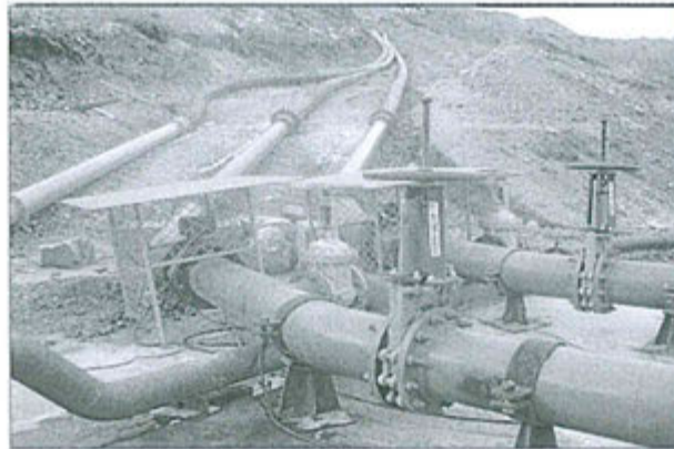
FOTO N° 7 Vista de las tuberías de solución lixivante, obsérvese las fugas.
