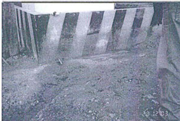
FOTO N° 9.- Vista de un muro de contención, obsérvese la falta de un receptor para derrames de combustibles.
