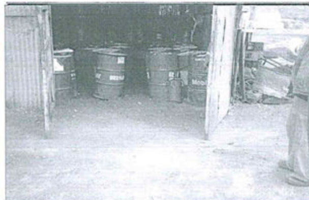
FOTO N° 13 Vista del local de combustible, obsérvese el piso sin impermeabilizar contrata San Simón.
