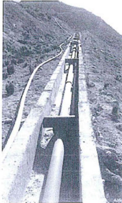
Foto N° 1: Canal de contención a lo largo de tubería de Relleno en pasta
