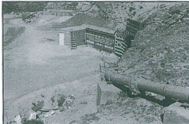
Fotografía 24: Tramo de tubería sin canal de contención de derrame
