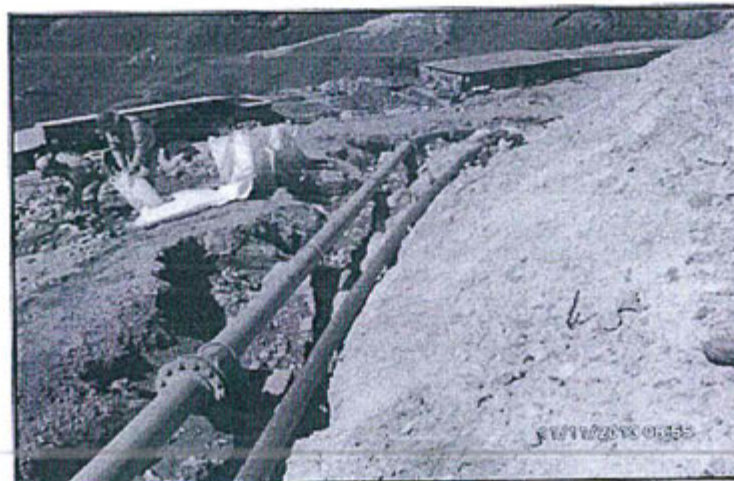
Fotografía 21: Tramo de tubería contenido en canal de contingencia de tierra
