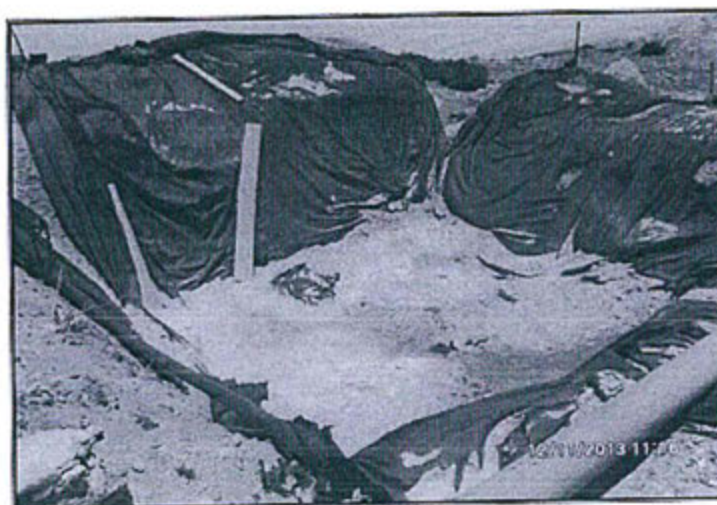
Fotografía 28: Poza de contingencia con mantas de protección rotas y con material de descarte
