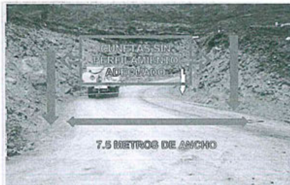
Fotografía N° 3 del Informe de Supervisión: Vía de acceso hacia el portal del túnel de exploración Ollachea, la vía cuenta con cunetas de drenaje en construcción sin perfilamiento adecuado y el ancho de rodadura es de aproximadamente 7.5 m, Recomendación N° 1, PE Ollachea, 2011.
