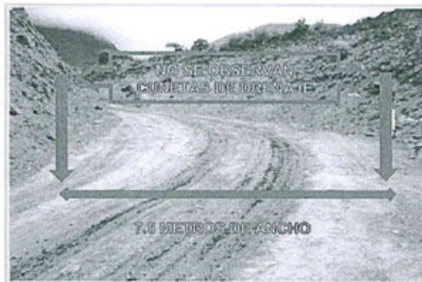
Fotografía N° 2 del Informe de Supervisión: Vía de acceso hacia el portal del túnel de exploración Ollachea, la vía no cuenta con cunetas de drenaje y el ancho de rodadura es de aproximadamente 7.5 m, Recomendación N° 1, PE Ollachea, 2011.
