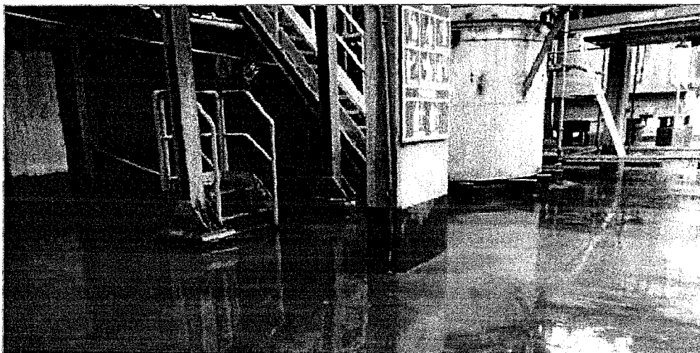
Fotografía 3. Piso de torres de ácido de la planta de ácido sulfúrico
