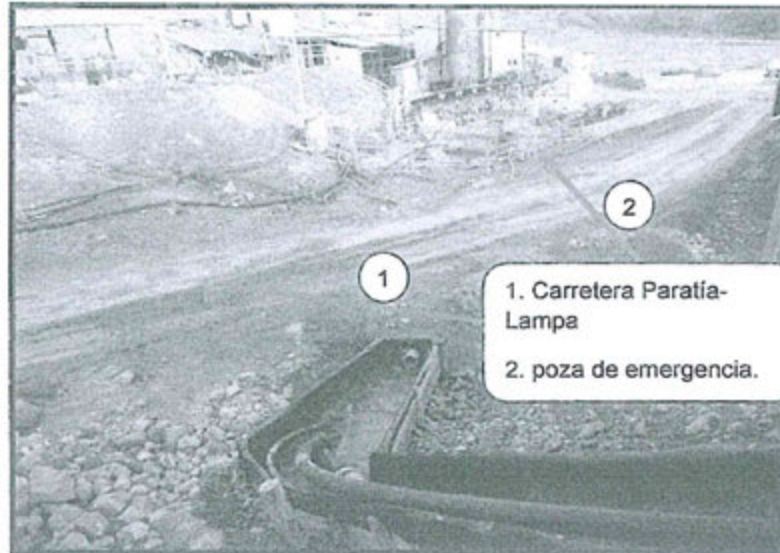
FOTOGRAFIA N°03: TUBERÍA DE 4" ENTERRADA DEBAJO DE LA CARRETERA, PARA TRANSPORTE DE RELAVE A LA POZA DE EMERGENCIA.
