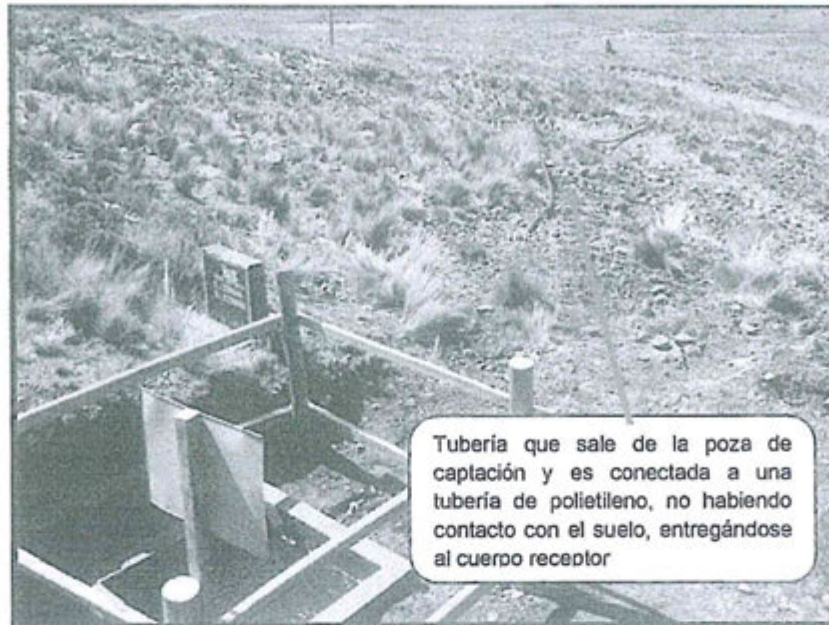
FOTOGRAFÍA N° 03: TUBERÍA PARA LA EVACUACIÓN DEL AGUA CAPTADA EN LA POZA.
