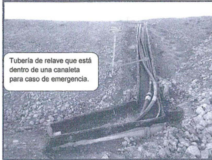
FOTOGRAFIA N° 01: CANALETA DE EMERGENCIA FORRADA CON GEOMEMBRANA.
