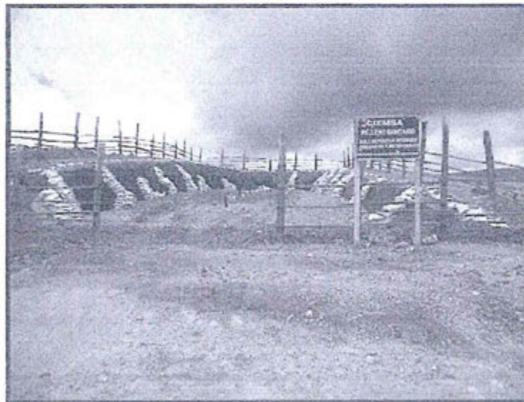
FOTOGRAFIA N° 01: VISTA PANORÁMICA DEL RELLENO SANITARIO DONDE SE APRECIA EL ORDEN Y LA LIMPIEZA.
