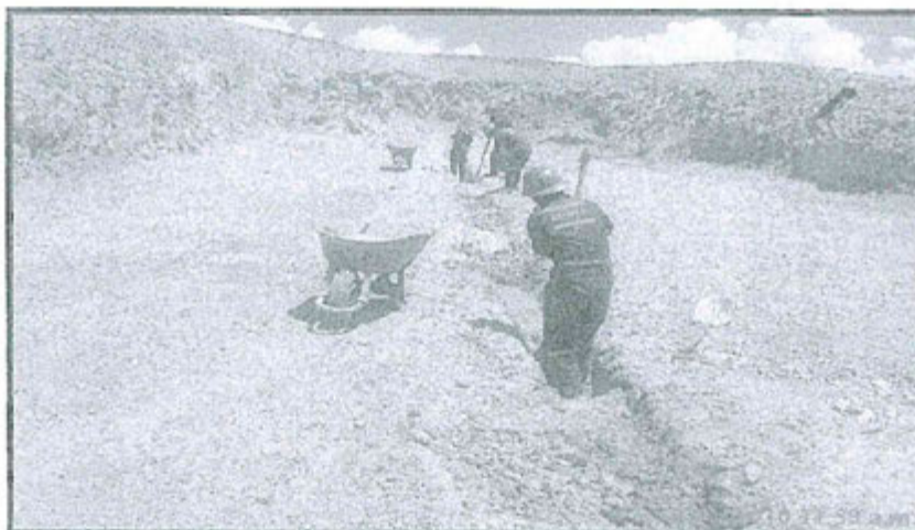
FOTOGRAFIA N° 4-02: CONSTRUCCIÓN DEL RELLENO SANITARIO DONDE SE OBSERVA LA CONFORMACIÓN DE LA ZANJA PARA INSTALACIÓN DE LOS DRENES DE COLECCIÓN DE LOS LIXIVIADO.
