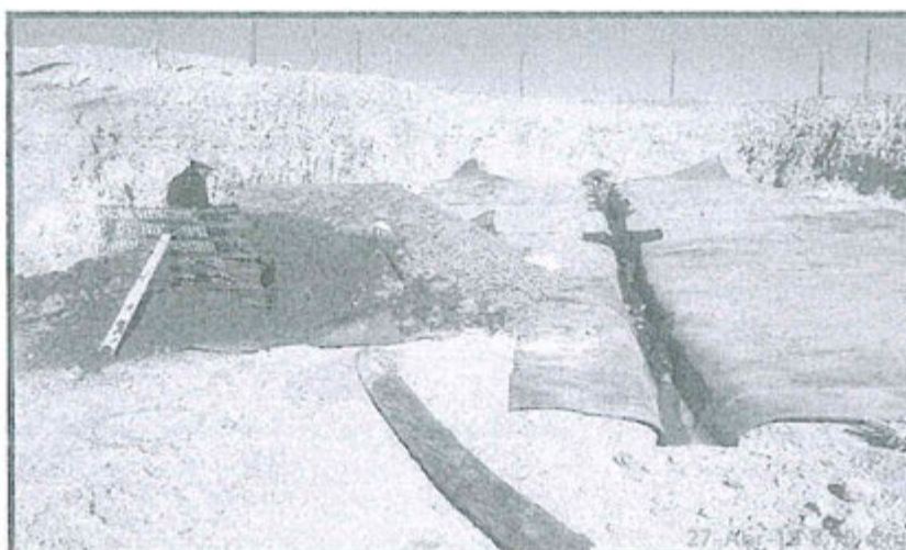
FOTOGRAFIA N° 4-03: TENDIDO DE GEOMENBRANA, NOTESE LOS DRENES COLECTORES DE LIXIVADOS, CONSISTENTE EN TUBERIA CORRUGA ENVUELTA EN GEOTEXTIL.
