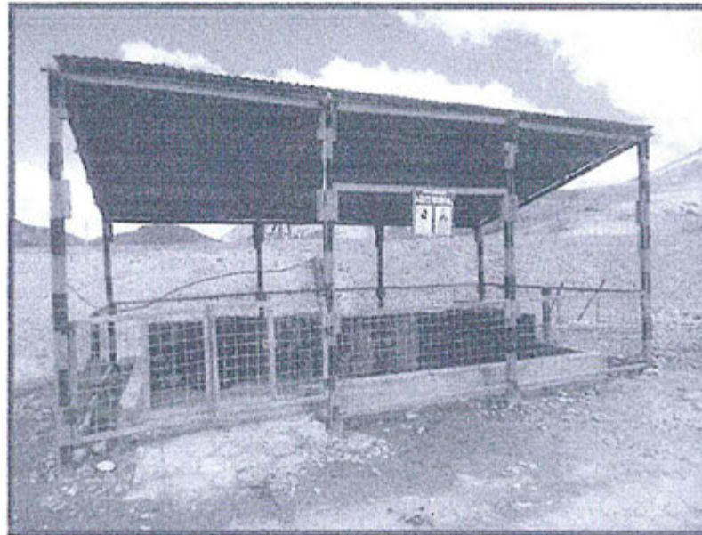
FOTOGRAFIA N°05: ESTACION DE TRANSFERENCIA DE RESIDUOS PELIGROSOS ACEITES Y GRASAS
