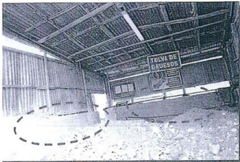
Foto 35: TOLVA de gruesos sin rociadores de agua.
