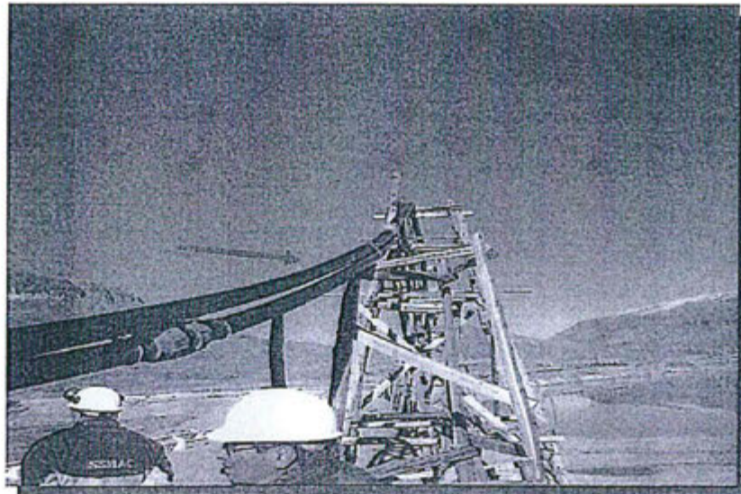
Foto 48: Tuberías HDPE de 4 pulgadas utilizadas para el transporte de relaves.
