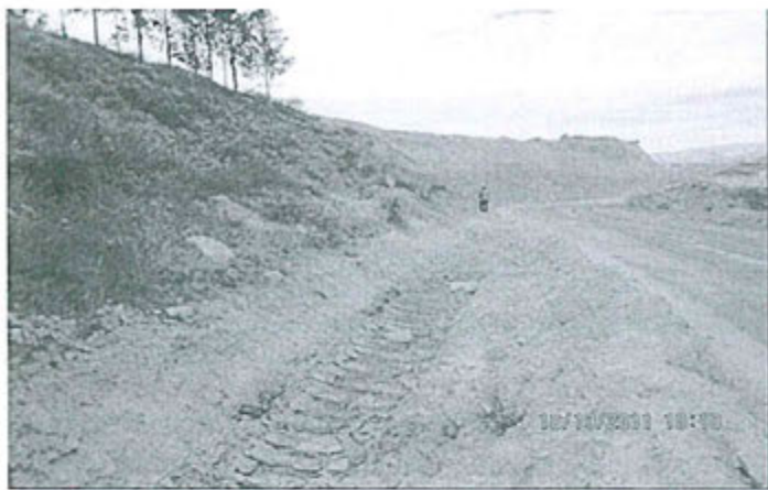
Foto 34: Tajos Cochavara, Seductora, Sacalla y Clarita, sin culminar con la construcción de las estructuras hidráulicas (canal de coronación, escorrentía y otros).
