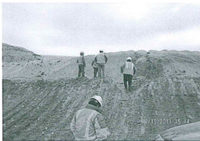
Foto 11: Botadero de desmonte sin muro de contención.
