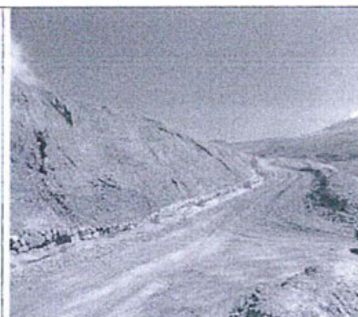
Infraestructura Hidráulica Tajo Sacalla Canal perimetral con geomembrana
