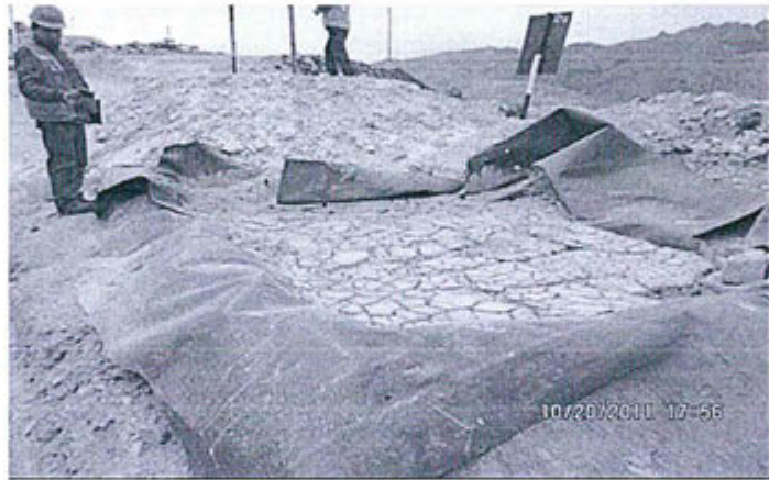
Foto 38: Zona de lavado de equipos de la Contrata San Simón, observese la generación de lodos por el lavado de las unidades motorizadas, las cuales se encontraban dispuestas sobre geomembrana rotas y mal colocada con posible impacto potencial.
