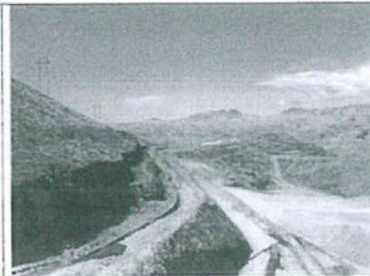
Canal perimetral tajo clarita por donde se deriva las aguas de escorrentía superficial
