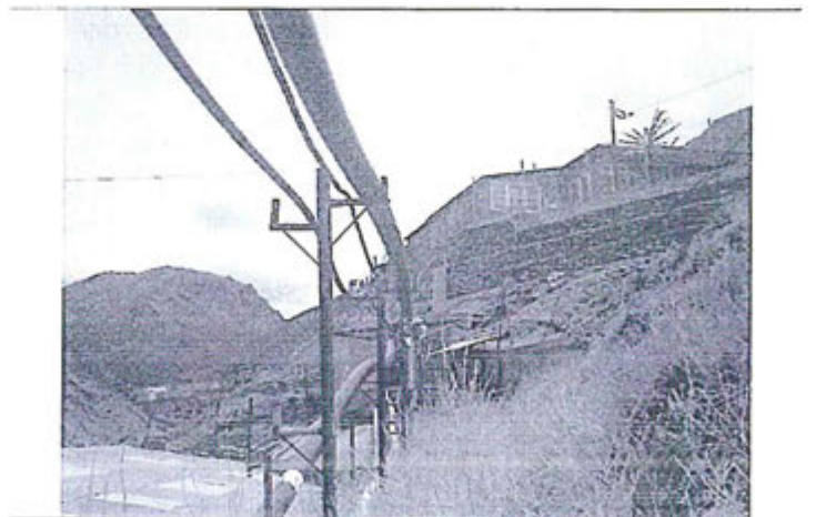
Fotografía (03-11-2012) N° 5. Poza de contingencia que se encuentra conectada a la tubería de relave de la bomba Metso 1 y la zona impactada por el derrame (Flecha roja)
