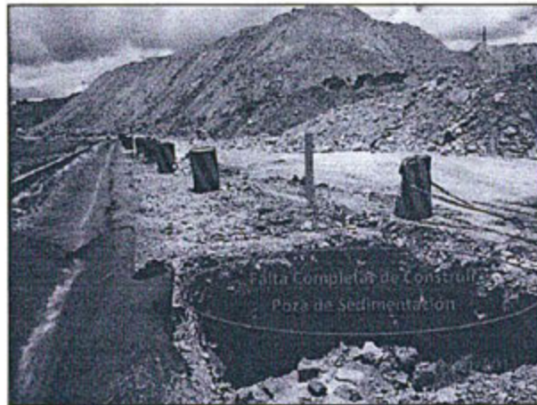
Fotografía N° 31 del Informe de Supervisión: Nótese que falta completar de completar de construir la poza de sedimentación del depósito de desmontes, la cual recibiría las aguas de su drenaje y subdrenaje.
