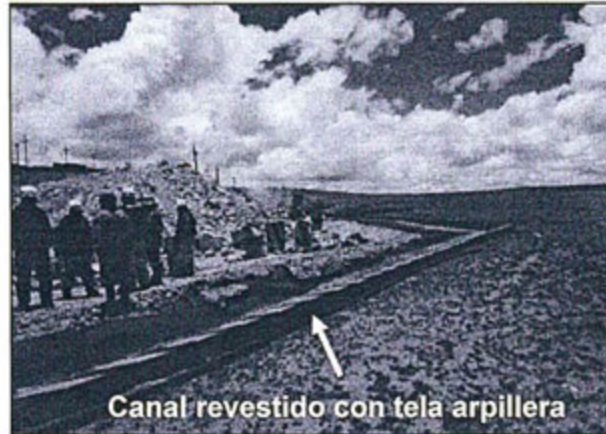
Fotografía N° 30 del Informe de Supervisión: Nótese la falta de mantenimiento del canal de coronación del Depósito de Desmontes.
