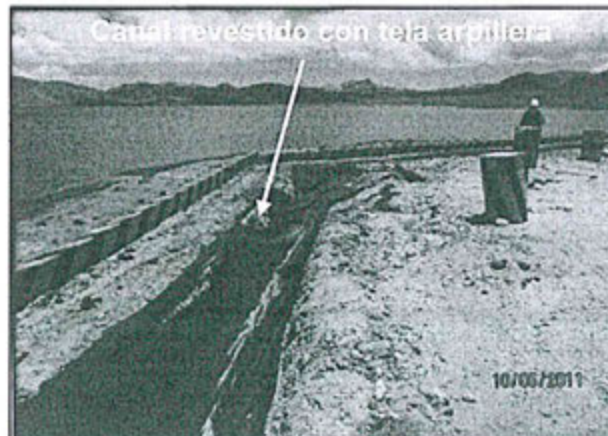
Fotografía N° 29 del Informe de Supervisión: Nótese el canal de coronación construido sobre suelo natural y revestido con tela arpillera debiendo ser de concreto armado de espesor de 0.15m.
