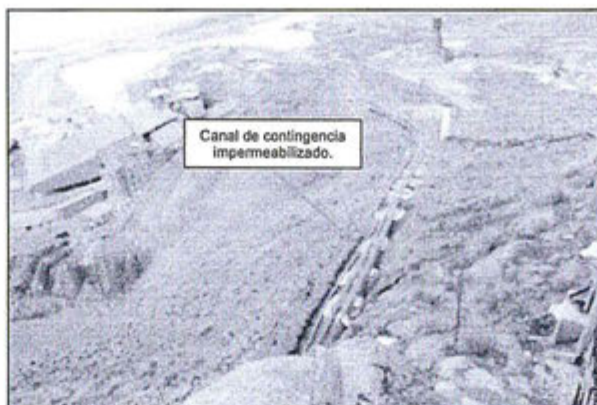
Fotografía N° 58: Cumplimiento de Recomendación N° 5, 2011: Canal de contingencia impermeabilizado por donde van las tuberías de relave desde la planta de relleno hidráulico hacia el cono profundo (sedimentador) de relave en pasta.
