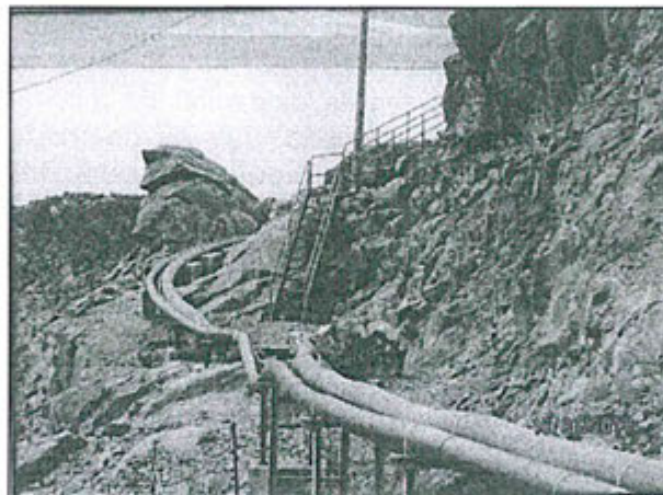
Fotografía N° 7 del Informe de Supervisión: Tubería que conduce relave, desde la planta de relleno hidráulico hasta la planta de relave en pasta, no cuenta con un sistema de contención para contingencias, que de producirse impactaría negativamente a los suelos.
