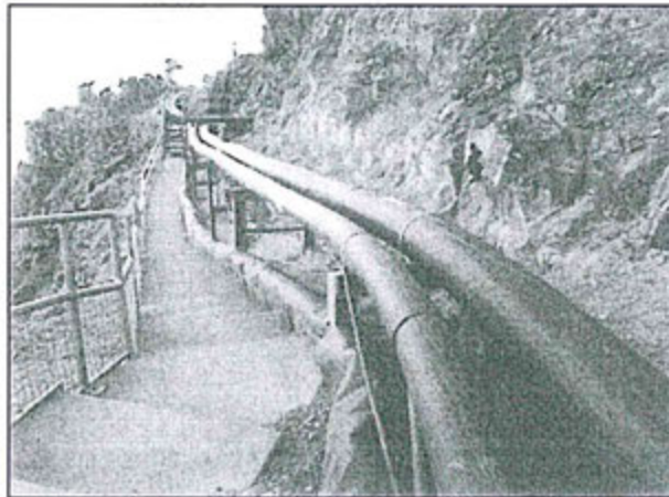
Vista del sistema para contingencias en la tubería que transporta de relave, próxima a la Planta de Relave en Pasta
