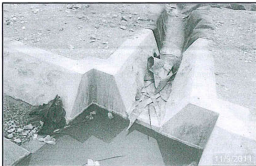
Foto N° 2.38: Residuos en cunetas del PAD.
