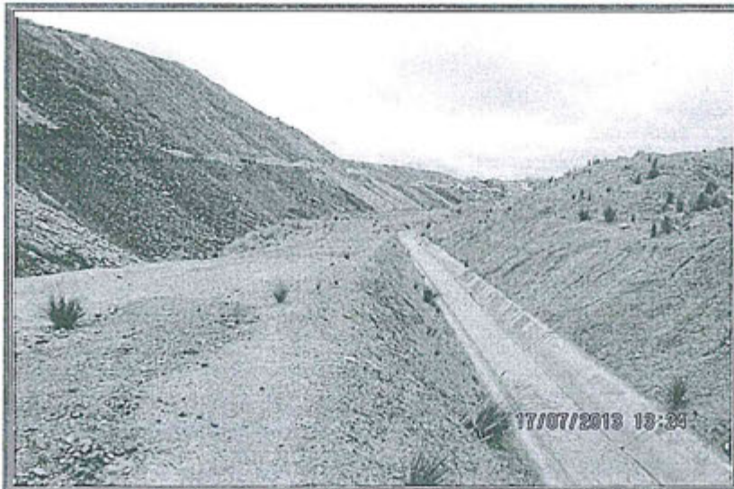
Fotografía N° 5: Hallazgo N° 1 Depósito de Desmonte Excelsior. En la Supervisión se constató que en el Pasivo Ambiental Depósito de Desmonte Excelsior, no se realiza ninguna actividad de cierre. Talud Este.
