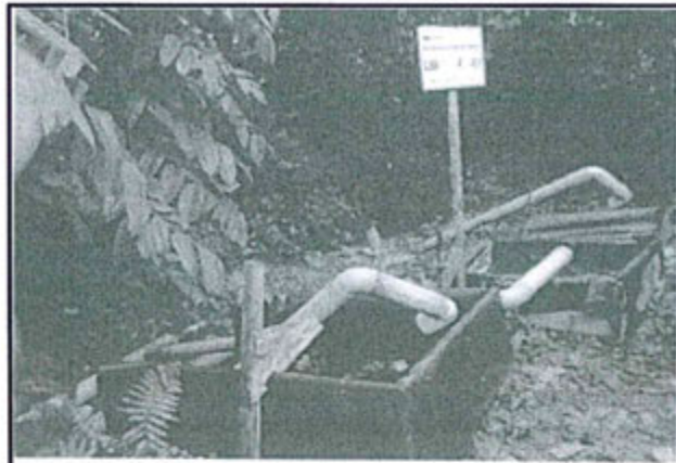
Figura N° 42. En el registro fotográfico se evidencia las tres tuberías que se vienen utilizando para la descarga de efluentes provenientes del Campamento Base Malvinas, en la coordenadas 723741 E y 8691162 N.
