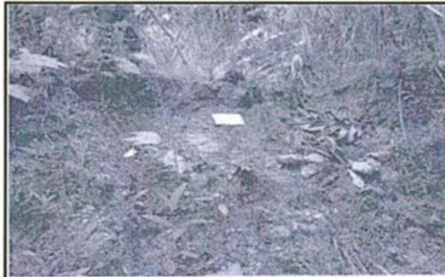
Figura N° 15. En el registro fotográfico se evidencia erosión de suelo en un talud del flow line, coordenada 750395 E y 8683452 N (referencia aproximadamente a un kilómetro del Km 39, en dirección hacia la locación Cashirari 1), área afectada aproximadamente de 20 m 2 .
