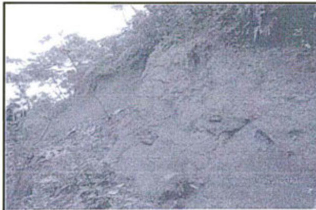
Figura N° 16. En el registro fotográfico se evidencia erosión de suelo en un talud del flow line, en la coordenada 749743 E y 8684132 N (referencia trayecto del Km 39 hacia la locación Cashirari 1), área afectada aproximadamente de 40 m 2 .
