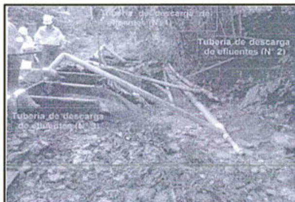
Figura N° 41. En el registro fotográfico se evidencia de tres tuberías utilizadas para la descarga de efluentes provenientes del Campamento Malvinas, en la coordenadas 723741 E y 8691162 N.
