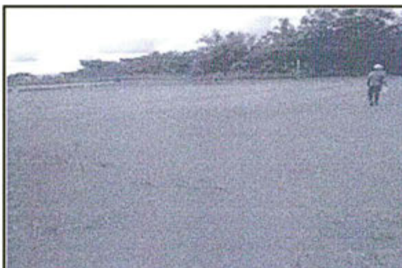
Figura N° 11. Registro fotográfico se muestra un área del helipuerto ubicado en la locación Cashirari 1, aproximadamente 400 m 2 , en la cual se evidencia poca cobertura vegetal y sin protección del suelo, lo que estaría generando erosión hídrica y eólica. Coordenada 746850 E y 6686314 N.
