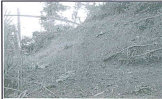
Figura N° 18. En el registro fotográfico se evidencia erosión de suelo en un talud del flow line, en la coordenada 748556 E y 8684448 N (referencia Kp 3 hacia la locación Cashirari 1), área afectada aproximadamente de 40 m 2 .
