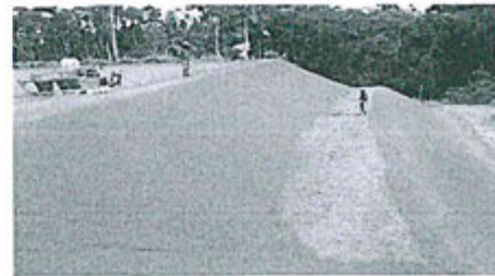
Foto N° 16: Vista final de la zona luego de la culminación de las tareas de control de erosión
