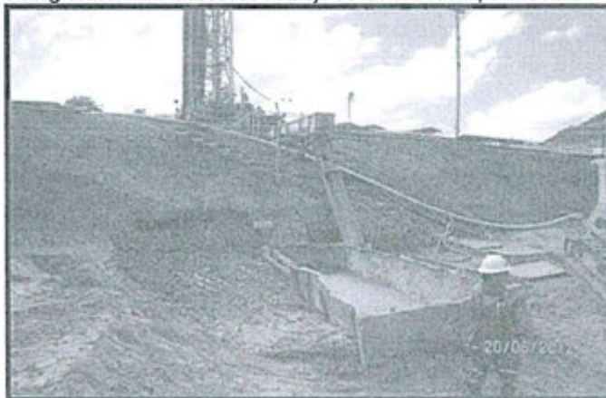
Fotografía N° 6: Inadecuado manejo de los cortes de perforación.
