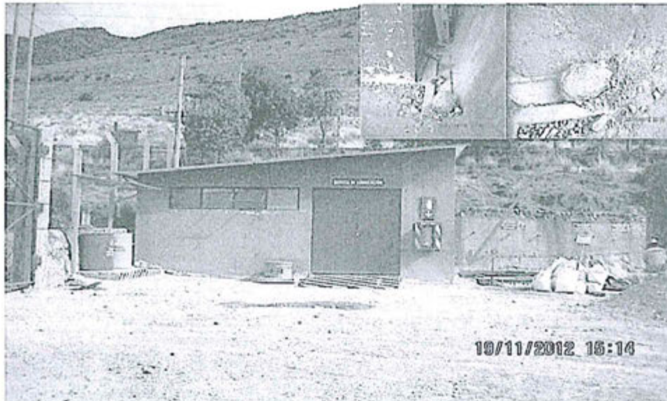
Fotografía N° 56.- Supervisión Regular 2012.- Observación N° 2.- En las instalaciones de la planta concentradora, se ubica un almacén de lubricantes, cuya poza de contingencias se encuentra destruida por las nuevas obras de concreto para la instalación de acumuladores eléctricos.
