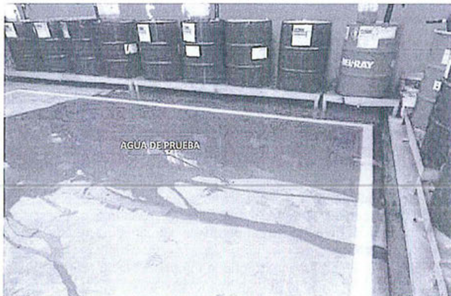
Fotografía N° 3.- Se puede observar la canaleta de recolección de derrame y las bandejas metálicas sobre el que están depositados los cilindros de lubricantes. Este sistema existente en el almacén de lubricantes nos otorga una capacidad de contención de 0.905 m3 ante un eventual derrame.
