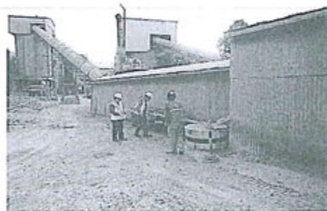
Fotografía N°1. Obsérvese los cilindros acondicionados ordenadamente en un espacio temporal y delimitados con cinta amarilla (de seguridad) debido a los trabajos de construcción de las paredes corta fuegos de la sub estación eléctrica. Así mismo, no se aprecia derrame alguno sobre el suelo que pueda impactar en lo más mínimo el suelo de esta zona.
