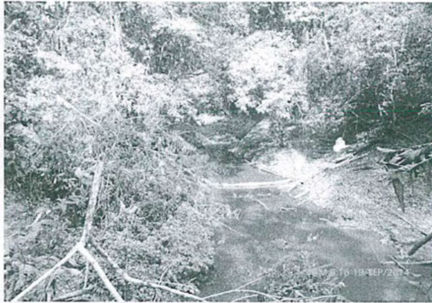
FOTO N° 25: Se observa otro punto del Canal de descarga natural de las aguas del Canal de flotación hacia el río Cuninico, se observa fluyendo agua de manera permanente a través de ella hacia el río Cuninico.
