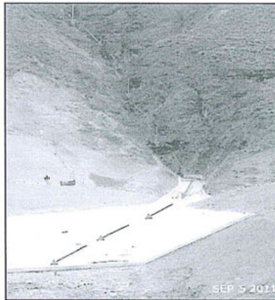
Fotografía N° 29: El canal de encausamiento de la Quebrada Intermedia hacia la quebrada Chinchán, no se encuentra concluido.
