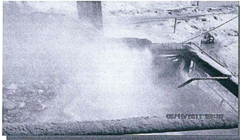
FOTO 57: Instalación de atomizadores de agua en la tolva de gruesos de la chancadora primaria de la planta N° 1 para mitigar polvos. Obsérvese los polvos generados.
