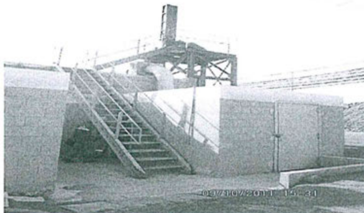
FOTO 67: Extractor de polvos y gases sin lavador de gases, laboratorio químico de planta
