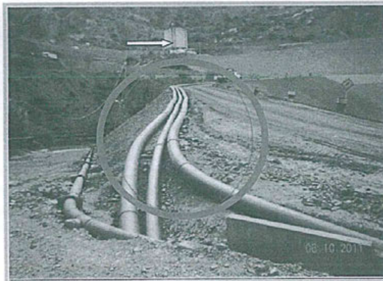
Fotografía N° 8: Sistema de Conducción de Relaves del Nido de Ciclones hacia el Espesador de Cono Profundo, en tubería HDPE, sobre terreno natural, no cuenta con sistema de contingencia ante eventuales derrames, UM Cobriza (Recomendación N° 4).
