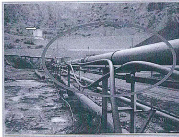
Fotografía N° 9: Sistema de Conducción de Relaves del Nido de Ciclones hacia el Espesador de Cono Profundo, en tubería de hierro, instalada sobre soportes metálicos, no cuenta con sistema de contingencia ante eventuales derrames, UM Cobriza (Recomendación N° 4).
