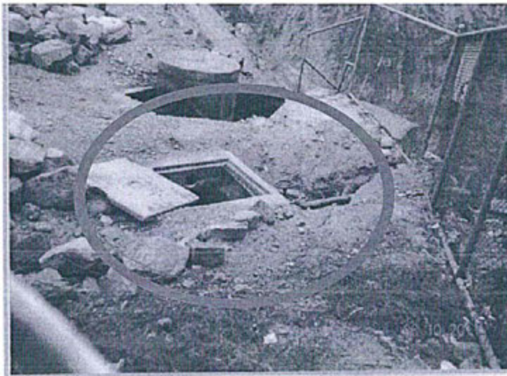
Fotografía N° 38: Caja colectora de Efluentes de la Planta de Tratamiento de Lodos Activados – PTAR, descarga hacia el Río Mantaro, el titular ha solicitado la inscripción del punto de monitoreo a la Autoridad Competente, sin embargo, no reporta los resultados de los análisis realizados, UM Cobriza (Implementación de Recomendación - 2010 N° 10 al 50%).
