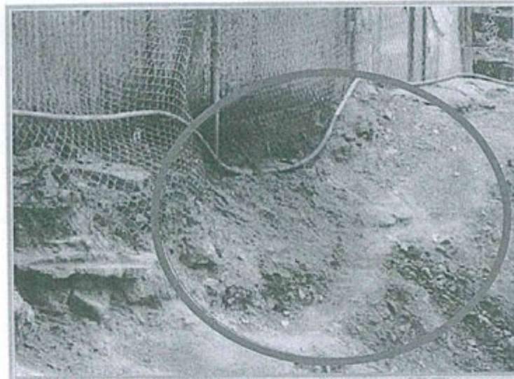
Fotografía N° 24: Disposición de lodos impregnados con hidrocarburos y minerales hacia la parte posterior del Taller de Geología en Pique Central, impactando directamente el entorno natural, UM Cobriza (Recomendación N° 11).
