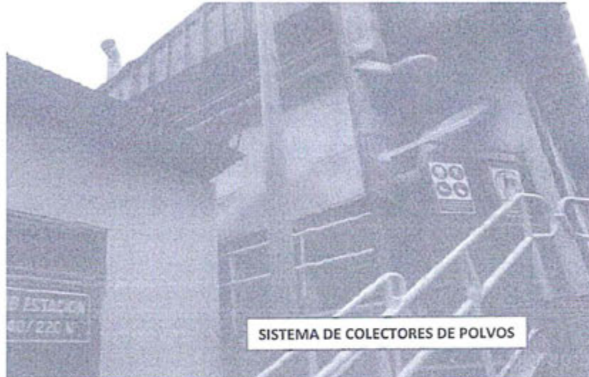
Fotografía VR N° 6: En el laboratorio químico se instaló sistemas de recuperación de polvos y vapores, a fin de evitar que afecten negativamente a la calidad de la atmósfera.
