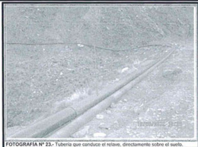
FOTOGRAFÍA N° 23.- Tubería que conduce el relave, directamente sobre el suelo.
