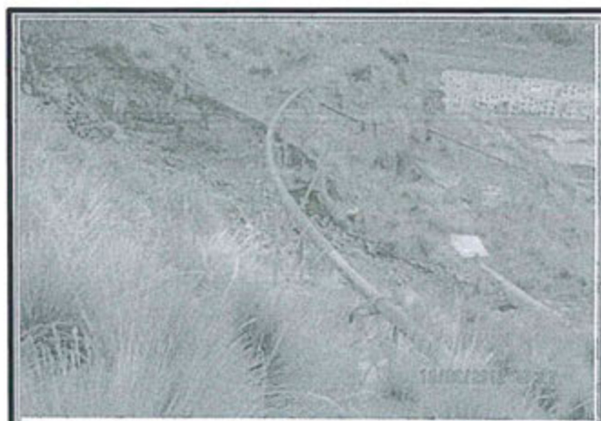
FOTOGRAFÍA N° 22.- Tubería que conduce el relave, soportado por estructuras metálicas.
