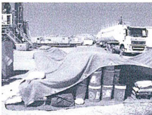
Foto N° 12. Lote X.- Los productos químicos para el Pozo (en perforación) 11208 – Taiman, no tienen las hojas de seguridad (MSDS) pegadas en los recipientes de cada producto.
