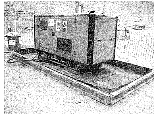
Vista 10. Detalle del sistema de contención del segundo grupo electrógeno.
