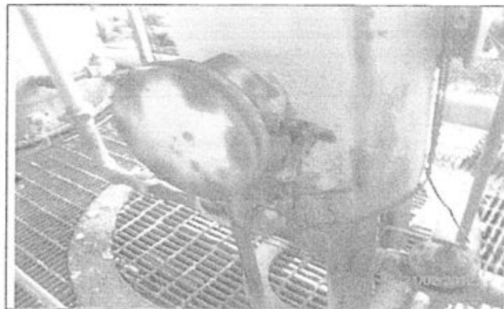
Fotografía N° 54: Plataforma SS, vista del área de proceso que no cuenta con un sistema de colección de fugas. Obsérvese corrosión en las bridas y parrillas impregnadas con hidrocarburos.
