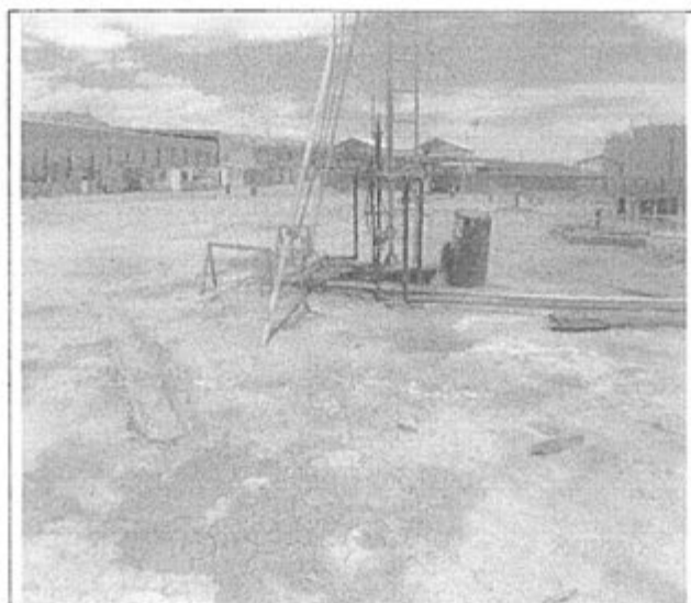
Fotografía N° 10: Se observa área de los pozos L1-10 y L1-8 con suelos afectados con hidrocarburos.
