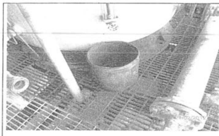
Fotografía N° 52: Plataforma PN-5, vista de goteo de hidrocarburos del tanque separador. Asimismo se evidencia parrillas impregnadas con hidrocarburos, tanque sin sistema de colección de hidrocarburos.
