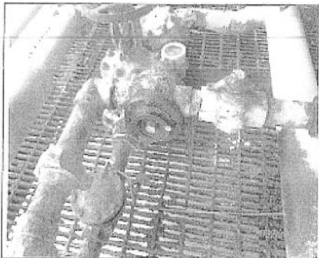
Fotografía N° 55: Se observa la Plataforma SS con bridas, parrillas y tuberías impregnadas con hidrocarburos.
