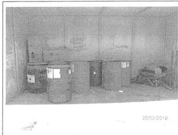
Fotografía N° 19: Batería L-1, Vista del centro de almacenamiento de lubricantes y químicos que no cuenta con sistema de doble contención
