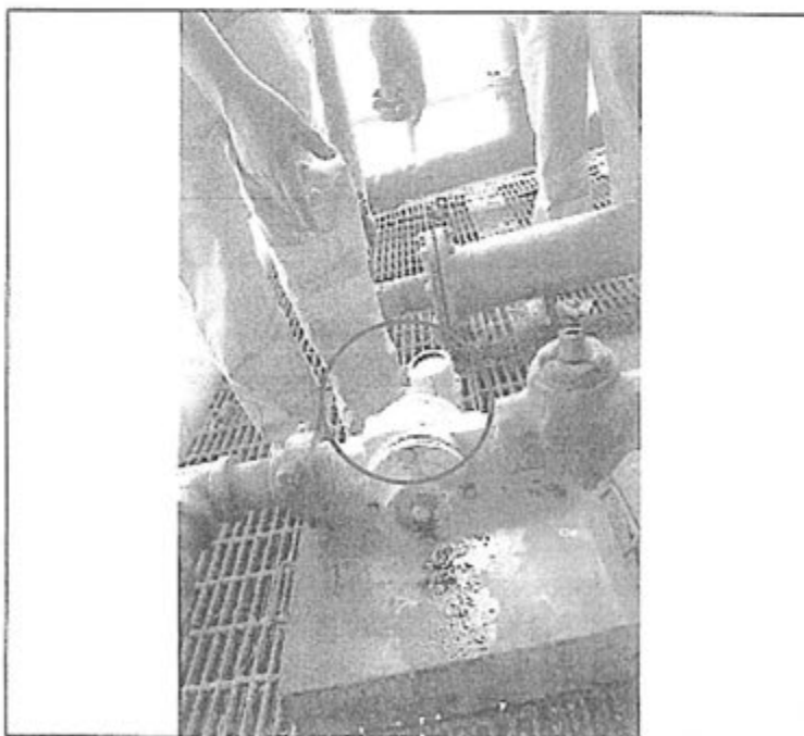
Fotografía N° 62: Se observa la Plataforma LT-4 con parrilla impregnada con hidrocarburos, tubería corroída y brida inadecuadamente cerrada.
