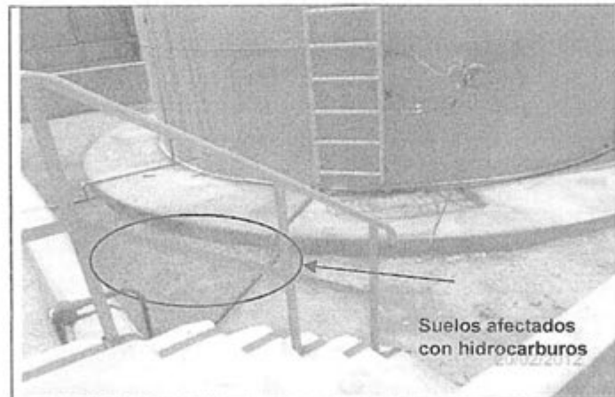
Fotografía N° 9: Vista del área estanca. Obsérvese suelos afectados con hidrocarburos que fue detectado organolépticamente (olfato) durante la supervisión.
