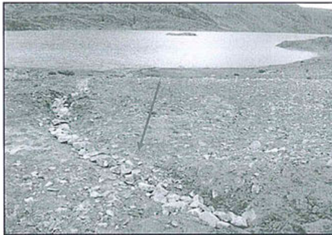
Foto 22: Observación 11, Transporte de las aguas tratadas mediante una tubería, para la descarga final en la laguna Huacracocha, en el punto de vertimiento y control denominado H-02, el que se encuentra sin identificación y señalización.
