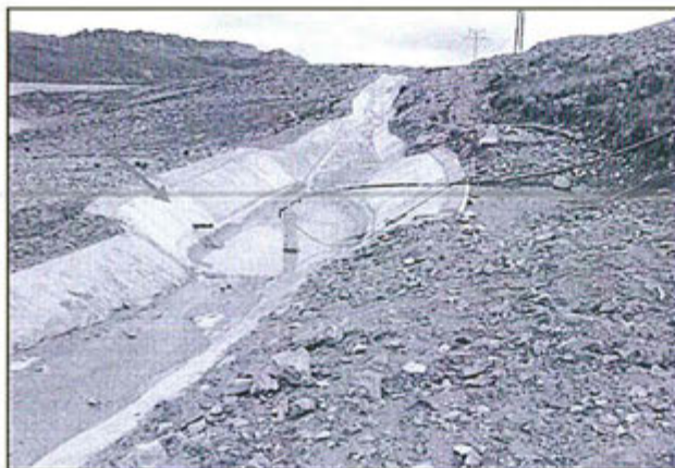
Foto 21: Observación 11, Poza de acumulación de las aguas provenientes de la planta de tratamiento Huacracocha y tubería empotrada para la descarga en el punto de vertimiento y control denominado H-02, el que se encuentra sin identificación y señalización.
