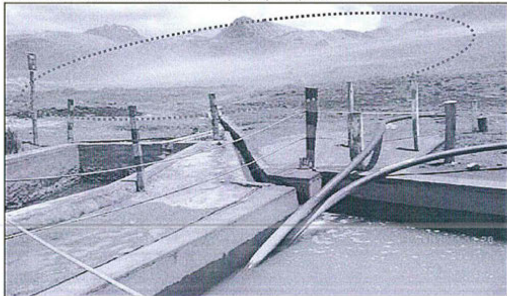
Foto 08: Observación 03, generación de polvos por erosión eólica, en el talud de la relavera antigua y poza de captación de aguas de subdrenaje.
