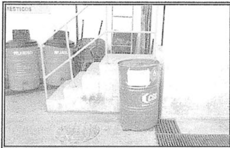
Vista 4. Vista fotográfica de cilindro metálico con contenido de disolvente eléctrico, sin contar con un sistema de contención en caso de derrame, ubicado en las instalaciones de la CH. Charcani VI, al costado del almacén temporal de residuos sólidos, en las coordenadas UTM: 8195850N / 0234060E.
