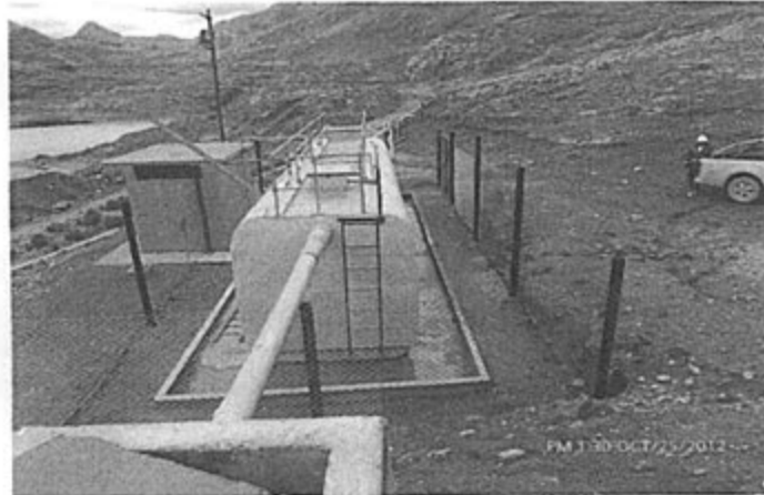
FOTO N° 65: Cumplimiento de Recomendación N° 10, 2011: Planta de tratamiento de las aguas residuales domésticas procedentes del campamento La Esperanza. Cuenta con su poza de contingencia y cerco perimétrico. Se encuentra en buenas condiciones.
