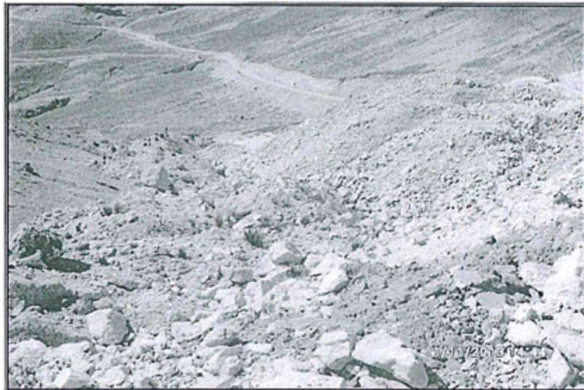
Fotografía 100: Hallazgo 3 – Depósito de Desmontes 1 no cuenta con canales de coronación para el desvío de aguas superficiales
