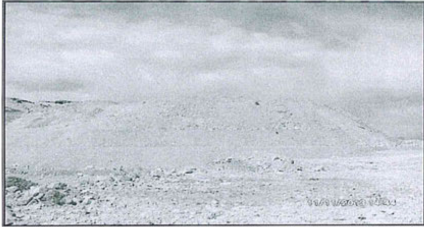
Fotografía 99: Hallazgo 3 – Depósito de Desmontes 1 no cuenta con canales de coronación para el desvío de aguas superficiales
