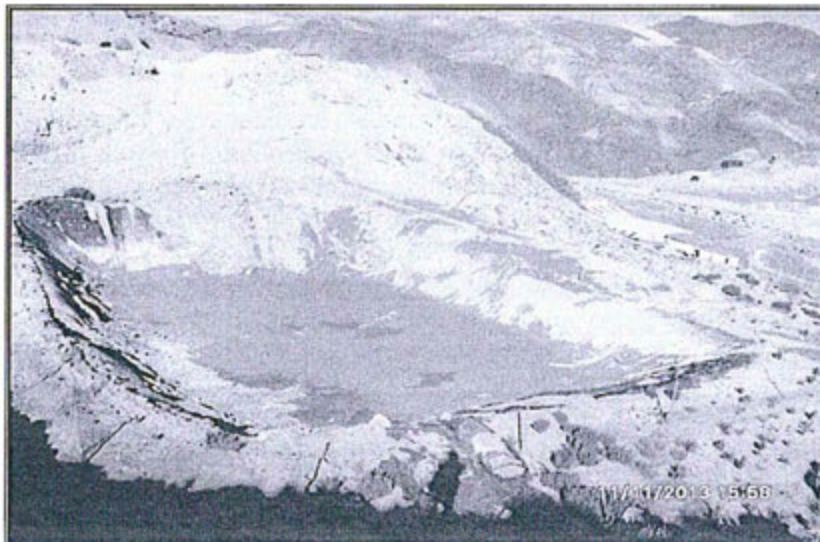
Fotografía 141: 6ta. Observación – NO LEVANTADA, persiste la rotura del geotextil, sedimentos en su interior y entorno, y falta de mantenimiento del canal de ingreso, de la Poza de Sedimentación del Depósito de Desmontes Pallancata
