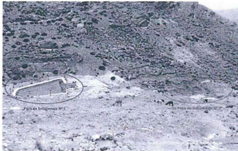
Foto N° 3. Retiro del cerco perimétrico y conformado de la poza de subdrenaje N° 2
