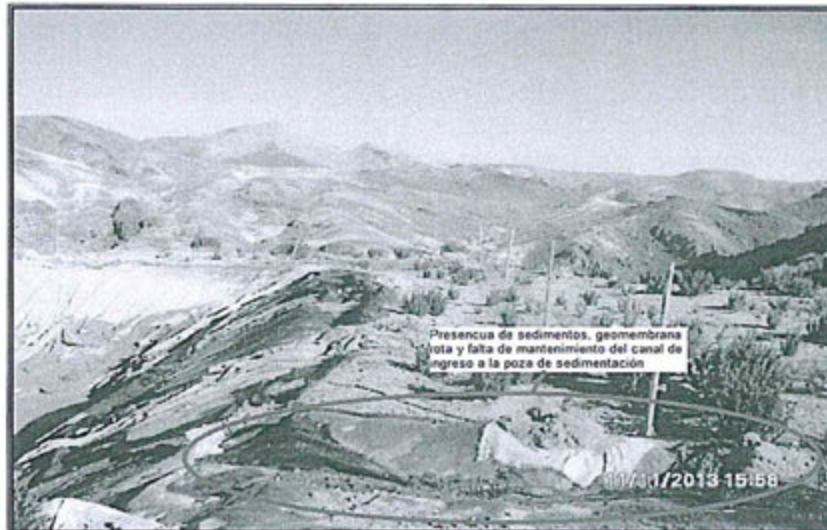
Fotografía 143: 6ta. Observación – NO LEVANTADA, persiste la rotura del geotextil, sedimentos en su interior y entorno, y falta de mantenimiento del canal de ingreso, de la Poza de Sedimentación del Depósito de Desmontes Pallancata
