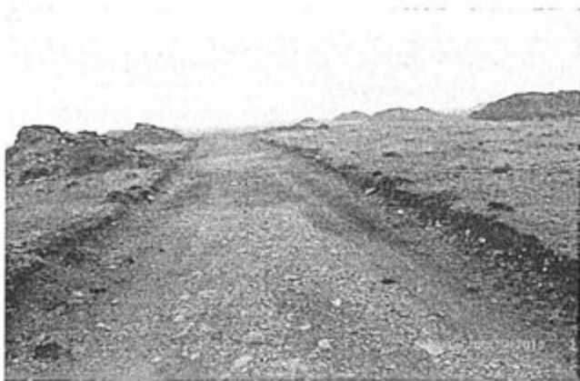
Fotografía N° 10. Vía de acceso que no cuenta con cunetas. Coordenadas UTM WGS84, N: 8804411 y E: 360457.
