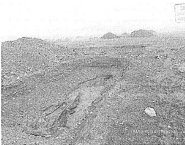
Fotografía N° 19. La tercera poza de lodos de la plataforma no identificada, con la geomembrana caída al centro de la poza.
