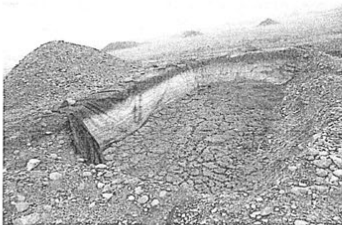
Fotografía N° 6. Poza (al extremo de la plataforma) con la geomembrana caída en dos lados, perteneciente a la plataforma de exploración SG-1070-2012. SG-1420-2012SG
