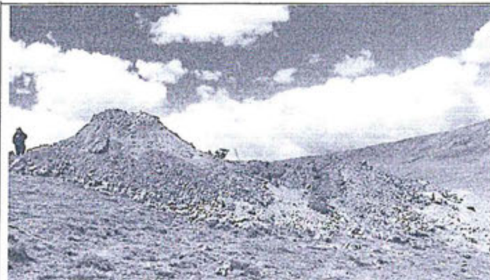
Vista Fotográfica N° 6: Nótese el material acumulado (tierra producto de la excavación) junto a las áreas donde se realizan las actividades de construcción de la L.T. 138kV
