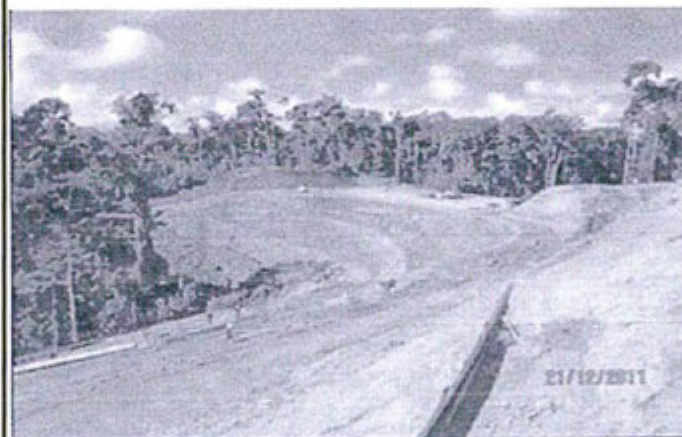
Fotografía N° 24: Inadecuado control de la erosión en la locación S
