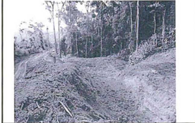
Foto N° 1.- Talud limpio de maleza y árboles talados; esta acción se repite a lo largo del DdV.
