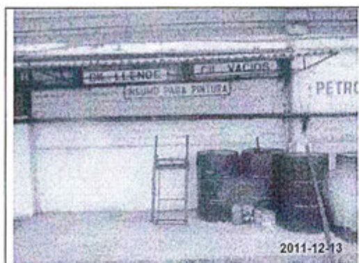
Fotografía N° 1: El Área del almacenamiento temporal de la Planta Envasadora de GLP, destinada a los productos químicos no cuenta con Sistema de Doble Contención.
