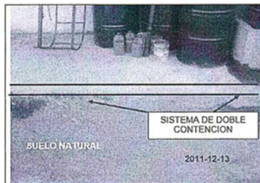
Fotografía N° 2: El Área del almacenamiento temporal de la Planta Envasadora de GLP, destinada a los productos químicos no cuenta con Sistema de Doble Contención.
