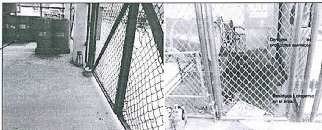
Fotografía N° 15: Vista del centro de almacenamiento de productos químicos y lubricantes. Obsérvese el área se encuentra impermeabilizada, sin embargo no se ha evidenciado la existencia del doble sistema de contención para derrames, requerido por norma.
