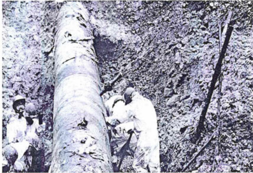
Foto 12: Vista cercana de zona de la tubería por donde fugaba el petróleo crudo, se observa una plancha metálica soldada a la tubería con un tapón y una válvula de 2" de diámetro.
