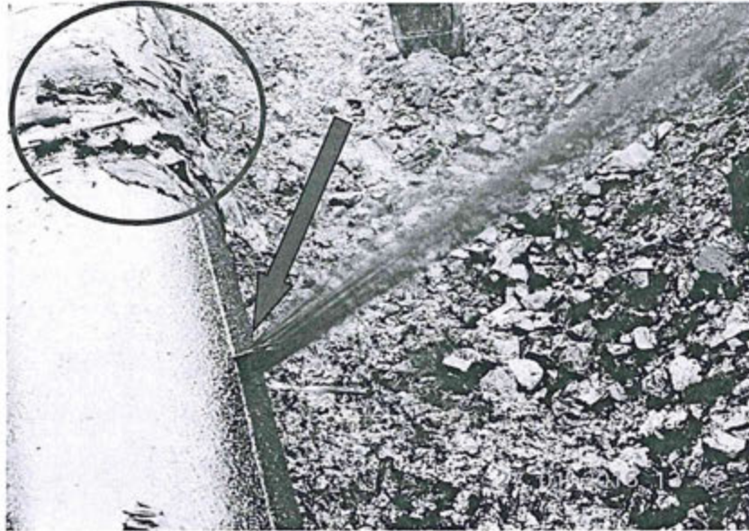
Foto 03: Se observa que el petróleo crudo está saliendo por una "falla" de la tubería de 36" de diámetro. Asimismo, se observa que el deterioro de la tubería se produjo por efectos de corrosión externa.
