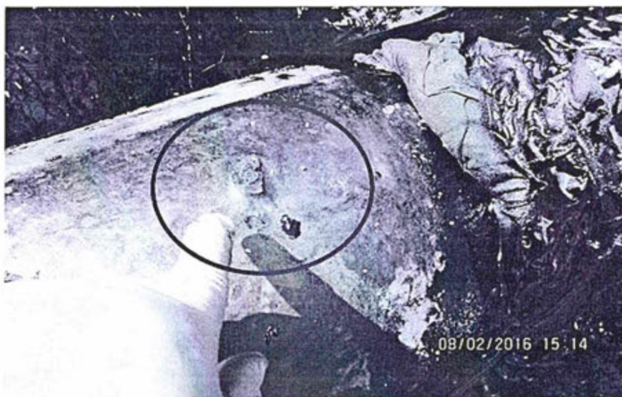
Foto 24: Muestra el desgaste y/o deterioro que ha sufrido la tubería por efectos de corrosión severa, los dos puntos muestran el estado inicial de la tubería. Coordenada WG84: 9524314N/0237150E.
