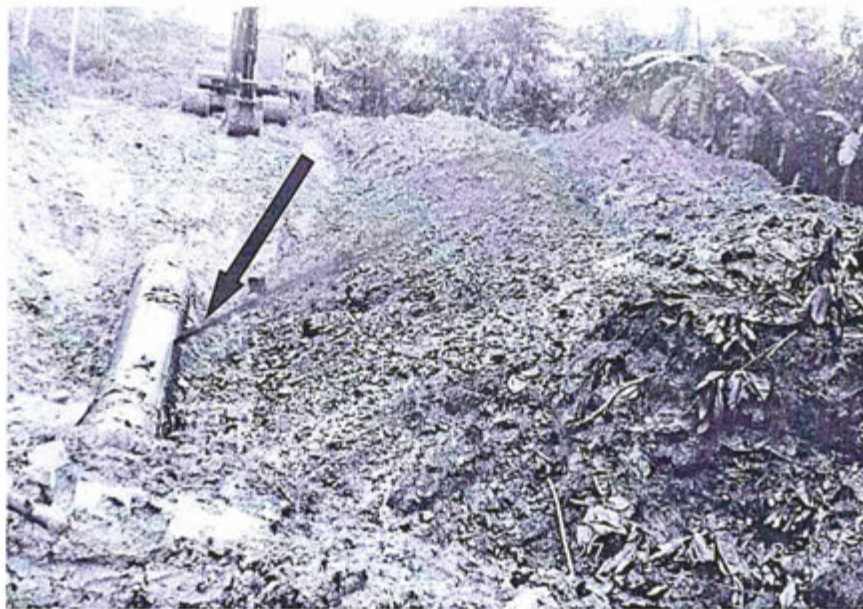
Foto 02: Se observa que el petróleo crudo no ha sido controlado, y se sigue realizando movimiento de tierra de la tubería en el Punto de falla.
