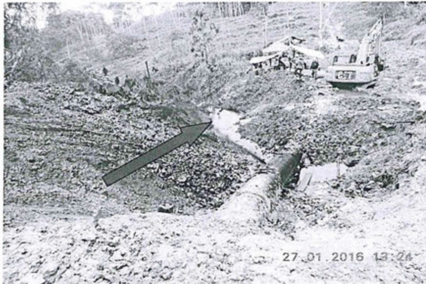
Foto 04: Se observa que el fluido del derrame sigue el cauce de una quebrada sin nombre (estacional) la cual es afluente de la quebrada Inayo.
