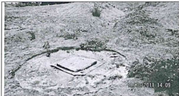
Foto 13: Tanque séptico N° 2 del comedor colapsado
