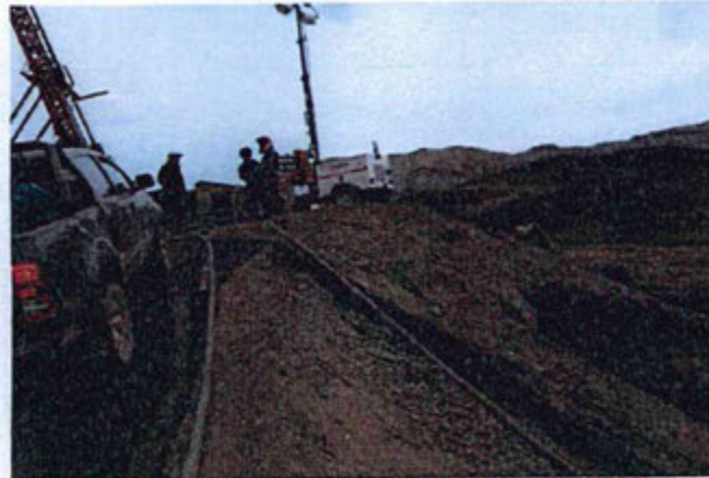
Fotografía N° 15: Aguas que ingresan a la perforadora discurrían por la plataforma y talud de la vía de acceso hasta el bofedal. Dichas aguas eran turbias por el arrastre de sedimentos.
