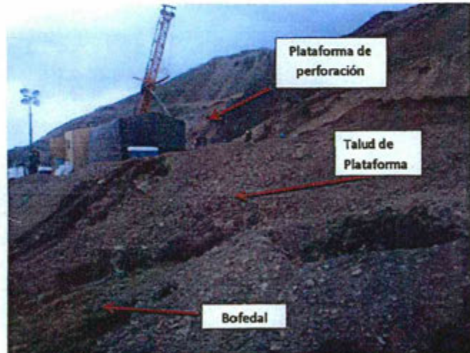
Fotografía N° 13: Plataforma de perforación del sondaje 41, el material de desbroce se ha almacenado en áreas colindantes con el bofedal.
