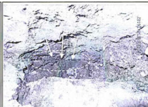
Foto N° 42: Se observa indicios de presencia de licor negro sólido que indicaría presencia de licor negro por posible infiltración.
