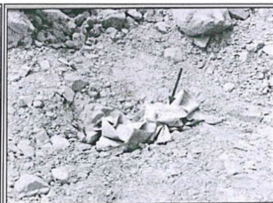
Foto N° 36: Se aprecia cintas de seguridad parcialmente enterradas dentro del ámbito de la cantera quebrada blanca.
