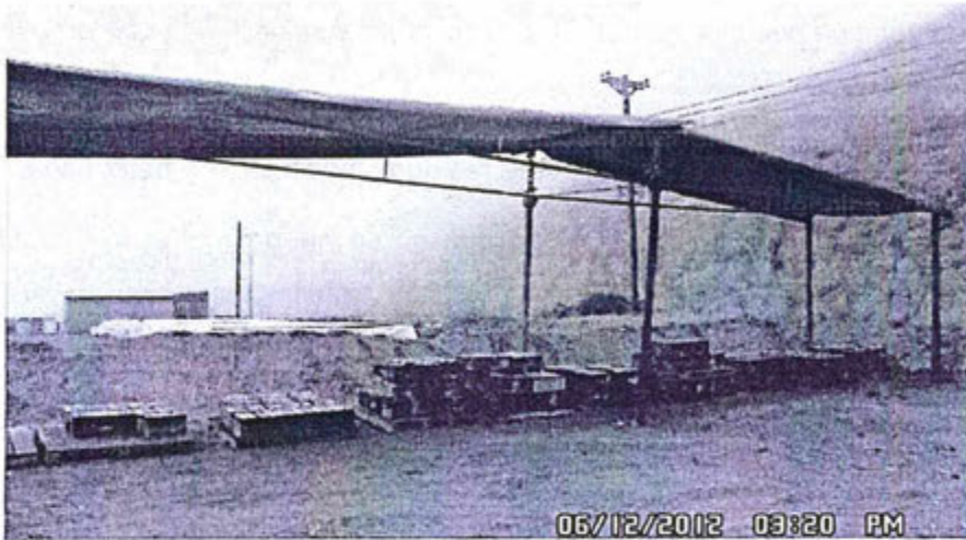
Fotografía N° 76.- Supervisión Regular 2012, Observación N° 6, Disposición de baterías usadas y otros residuos peligrosos, sin una medida de contención secundaria para la protección del suelo y no cuentan con barreras de protección.
