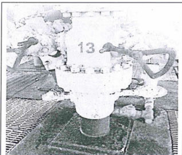
Fotografía N° 65: Plataforma PV-4, vista de parrilla y base del pozo impregnado con hidrocarburos
