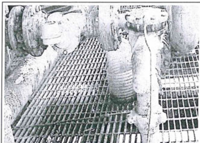
Fotografía N° 85: Plataforma LO-8, vista la parrilla impregnados con hidrocarburos y goteos provenientes de la brida.
