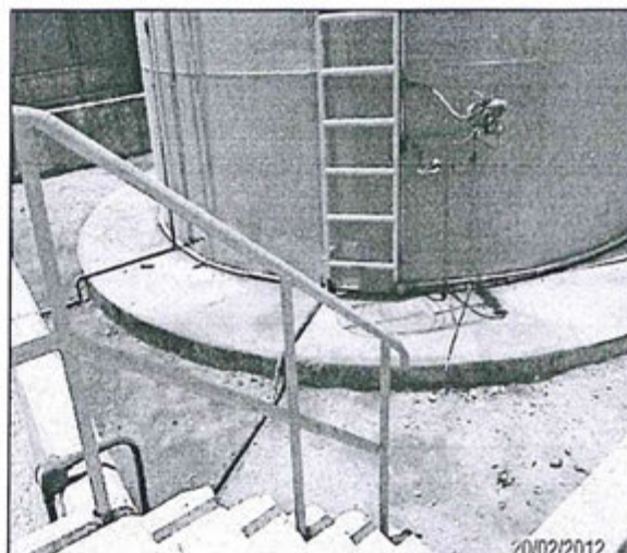
Fotografía N° 9: Vista del área estanca. Obsérvese suelos afectados con hidrocarburos que fue detectado organolépticamente (olfato) durante la supervisión.
