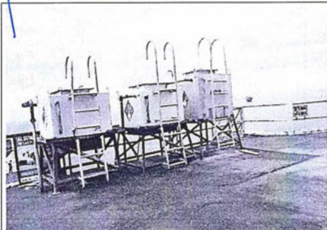
Fotografía N° 73: Plataforma LO-9, vista de restos de hidrocarburos impregnados en la plataforma que discurrieron de los tanques de almacenamiento.
