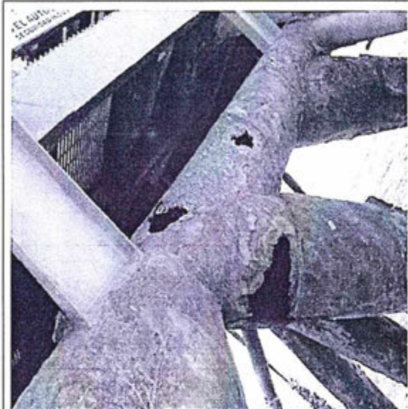
Fotografía N° 63: Se observa la Plataforma LT-4 con tubería (pilotes) con corrosión.
