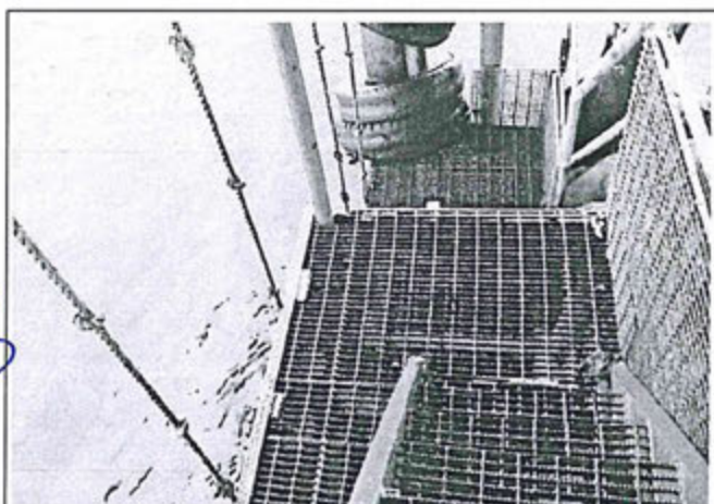
Fotografía N° 79: Plataforma LO-9, vista de la escalera y pasamanos, En dicho lugar se evidenció aceite y grasa impregnado en los pasamanos y parrillas de la escalera.
