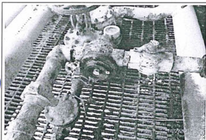
Fotografía N° 55: Plataforma SS, vista de la brida de cierre, parrilla y tuberías con restos de hidrocarburos.
