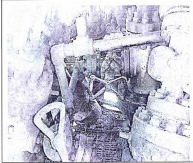
Fotografía N° 68: Se observa la Plataforma PG con pozos con presencia de corrosión impregnados con hidrocarburo impregnados en la plataforma y tubería.
