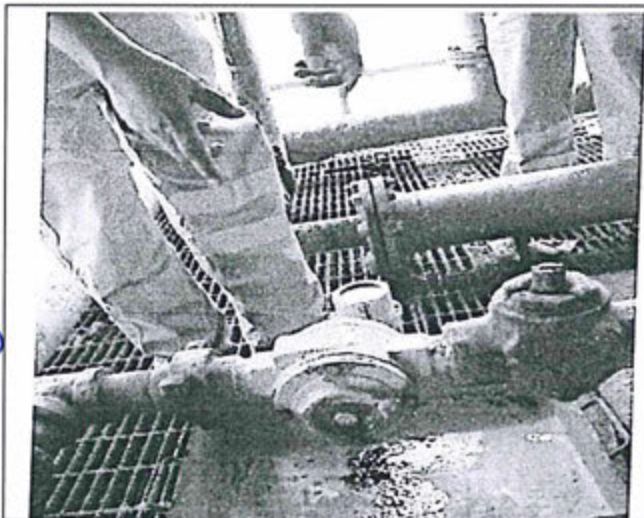
Fotografía N° 62: Se observa la Plataforma LT- 4 con parrilla impregnada con hidrocarburos, tubería corroída y brida inadecuadamente cerrada.
