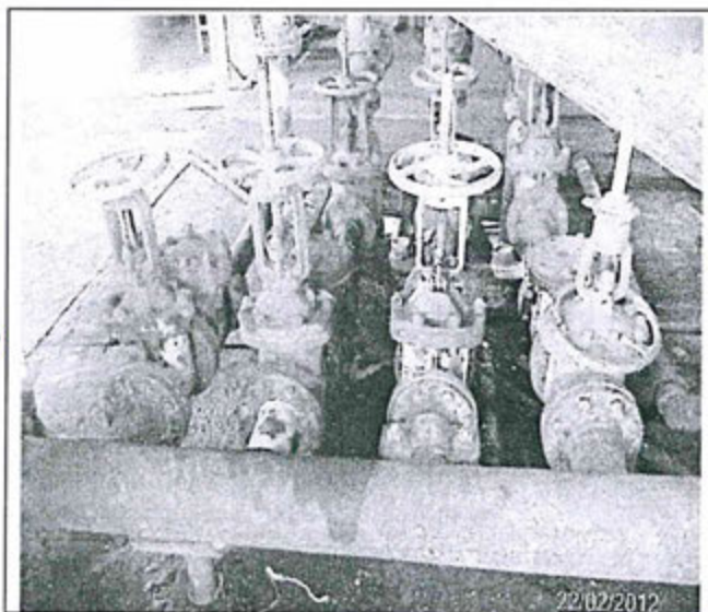
Fotografía N° 67: Se observa la Plataforma PG con manifold corroído y restos de hidrocarburo impregnados en la plataforma y tubería.
