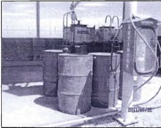
Fotografía N° 4: Vista panorámica del área de almacenamiento de combustibles líquidos y lubricantes de la Batería Providencia, se evidenció que no cuenta con un adecuado sistema de contención secundario que permita contener posibles derrames. (Énfasis agregado)
