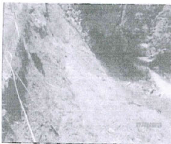
Vista de zona de erosión en Locación Mipaya.
