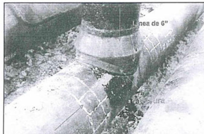
Fotografía N° 3: Vista de fisura ubicada en unión de ductos de 6" y 8".
