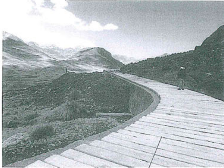
Techado del Canal Marcapomacocha para evitar su obstrucción por potenciales deslizamientos de la ladera
