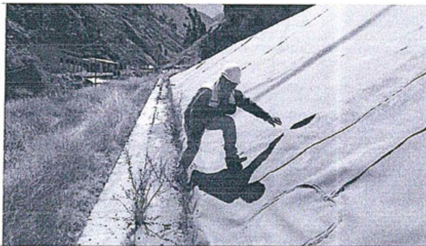
Fotografía N° 20. Abertura en la geomembrana del depósito de relave Triana en el sector de coordenadas 8 697 134N y 357 509E, presenta una abertura de aproximadamente 30 cm, que expone el material de relave encapsulado.
