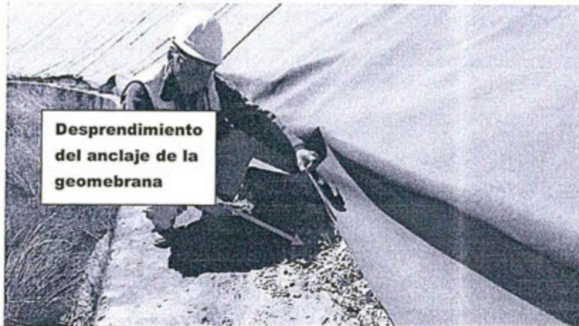
Fotografía N° 17. Otra vista del desprendimiento del anclaje de la geomembrana, en la base del depósito de relave Triana, situación que origina que los relaves al estar expuestos al ambiente al contacto con el agua de escorrentía, escurran con contenido de metales por el muro de contención del depósito en mención.
