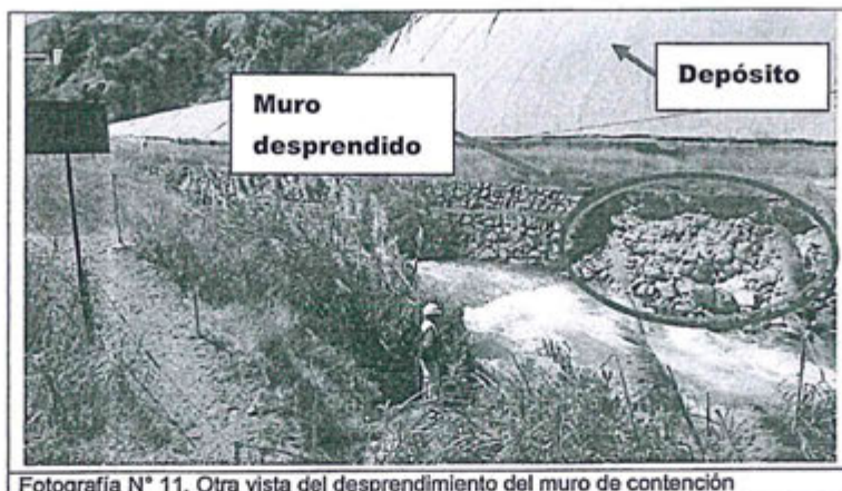
Fotografía N° 11. Otra vista del desprendimiento del muro de contención
