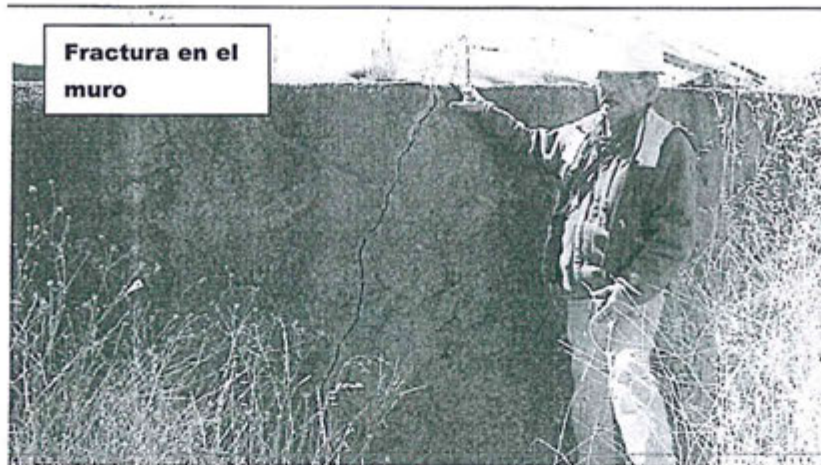
Fotografía N° 23. La fractura vertical presente en el muro perimétrico del depósito Triana secciona completamente al muro, con un desplazamiento vertical de 1 cm.
