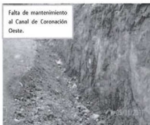
Fotografía N° 19: Falta de mantenimiento en parte del canal de coronación Oeste de la relavera Vaso Atacocha.
