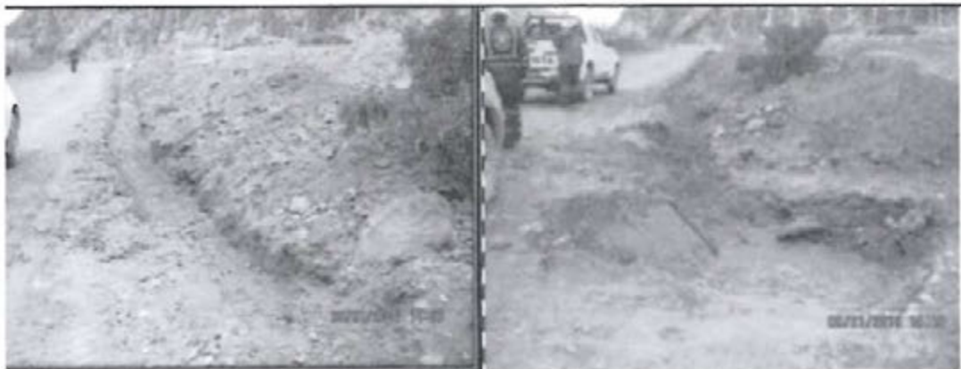
Fotografía N° 4: En el relleno sanitario Santa Bárbara falta completar el sistema de captación conducción y el tratamiento de los efluentes producto de las lixiviaciones orgánicas.
