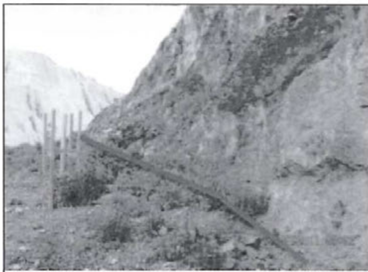
Fotografía N° 22: Falta de impermeabilización en el flanco sur del relleno sanitario Santa Bárbara.
